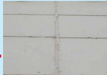
打膠完成後批土料，造成批土料汙染板縫
