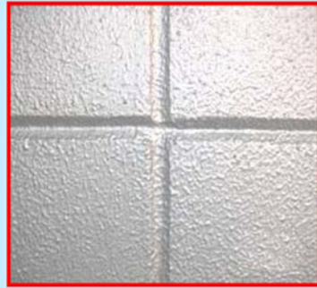
彈性塗料飾面，確保無裂縫
